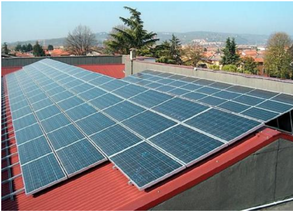
Alcuni pannelli solari sul tetto di un'azienda
